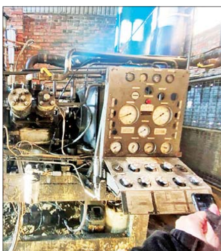
В ИП Кундрат незаконно были установлены более 30 приборов газового оборудования. Фото пресс-службы ООО «Газпром межрегионгаз Ростов-на-Дону».
